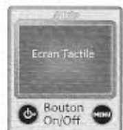
Panneau de commande et la chaudière sont à l'arrêt
